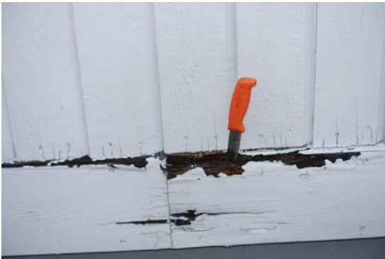
Del av gavl med råteskader.
