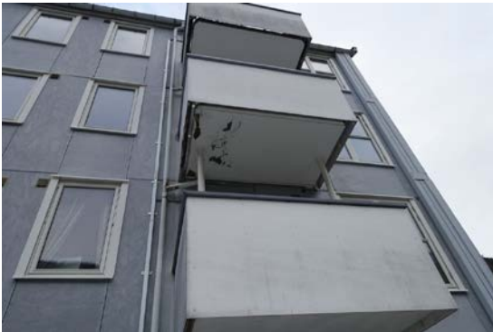
Balkonger med stort vedlikeholdsbehov, bør skiftes.
