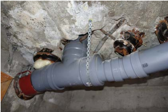
Gjennomføringer i etasjeskille uten branntetting.
