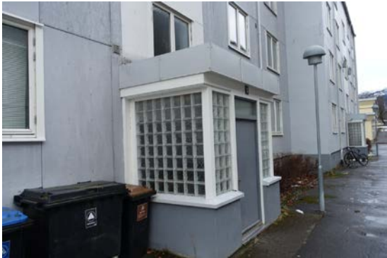
Inngangsparti anbefales utskiftet ved fasaderehabiliteringen.
