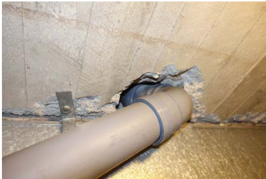
Manglende brannetting i etasjeskille.
