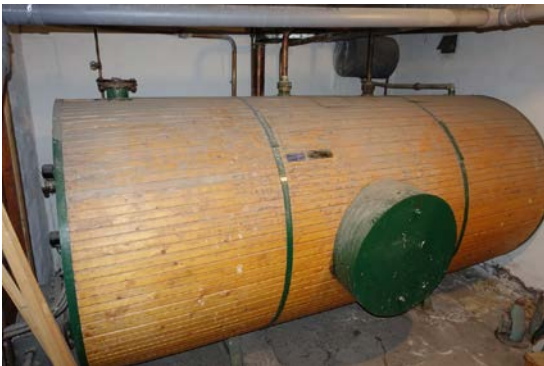
Eldre varmeanlegg som var til forbruksvann og radiatorer.
