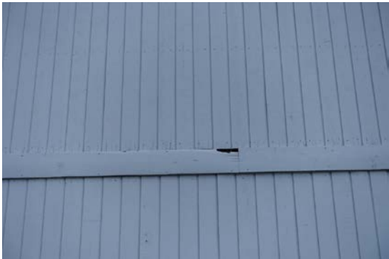
Kledning som sprekker og begynnende råde.
