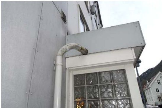
Lekkasje rundt nedløp.
