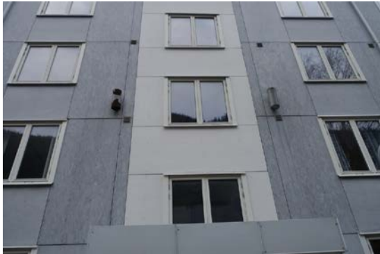
Vinduer i fasaden med generelt behov for overflatebehandling.
