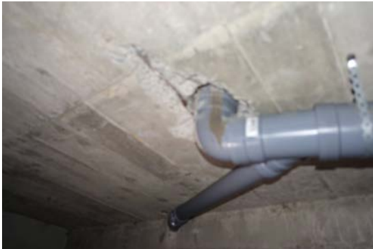
Gjennomføringer i etasjeskille uten branntetting.
