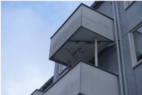
Balkonger med stort vedlikeholdsbehov, bør skiftes.
