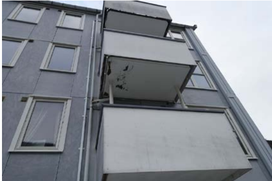
Vann gjennom dekke, synlig fra undersiden.
