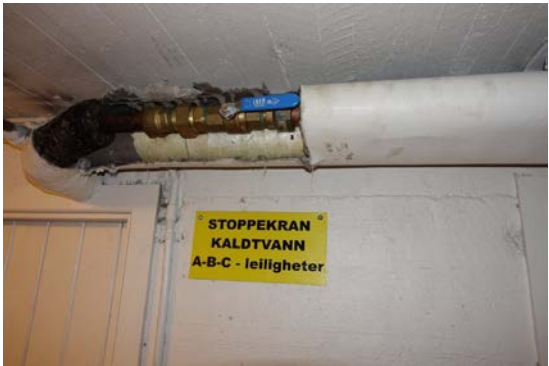
Godt merket stoppekraner.
