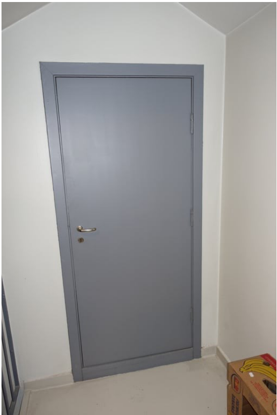
Eldre dører i brannskillende konstruksjoner.
