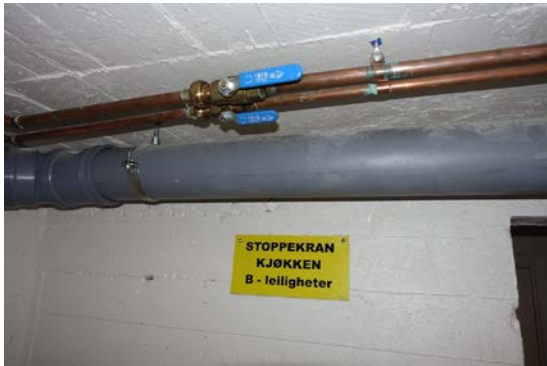
Godt merket stoppekraner.
