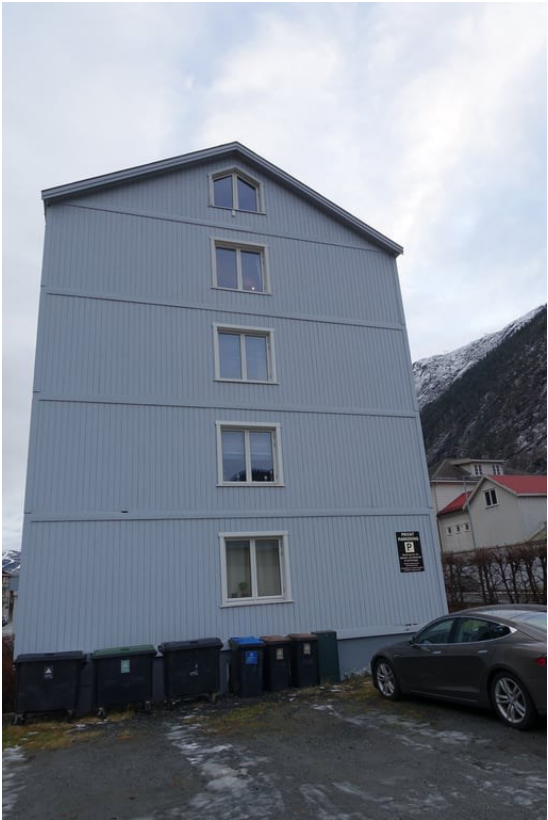
Bilde av fasade med akkumulert vedlikehold.
