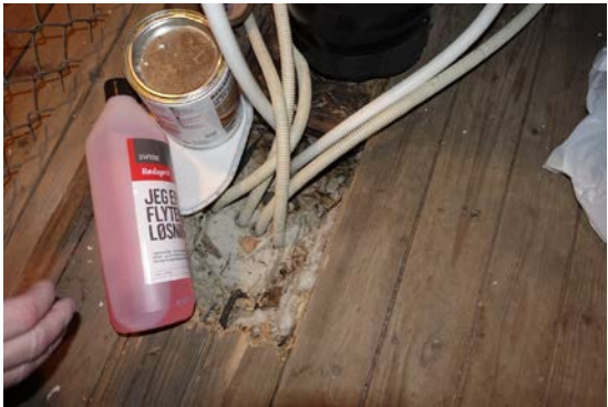
Manglende brannetting i etasjeskille.
