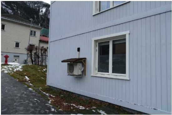
Ettermontert varmepumpe på fasade.
