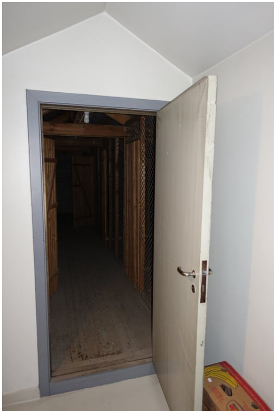
Eldre dører i brannskillende konstruksjoner.
