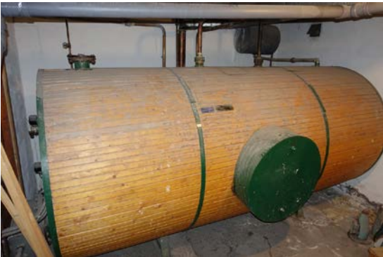
Opprinnelig varmtvanns kjel.
