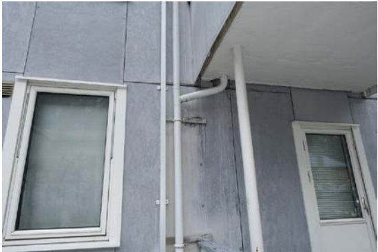
Vindu og balkongdør, behov for overflatebehandling.
