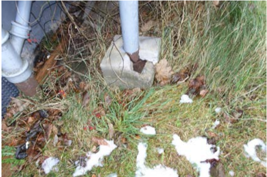
Fundament har sprukket.
