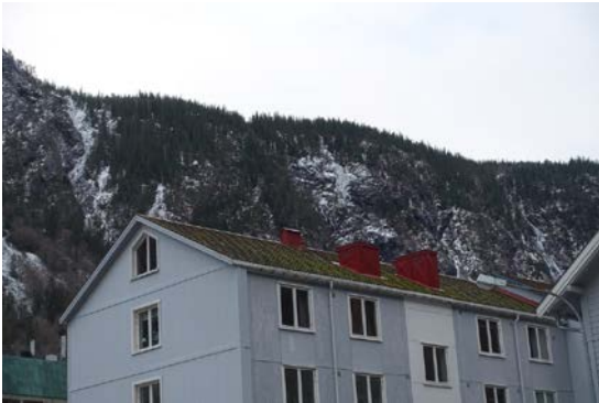
Tak mot nord med stedvis mye begroing.
