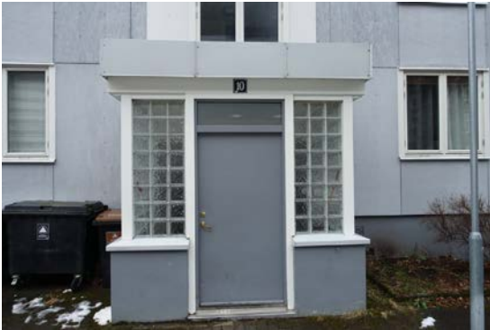
Eldre dør av tre som er trekkfull med skader på terskel.
