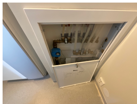
Rør i rør skap, Tappevann
