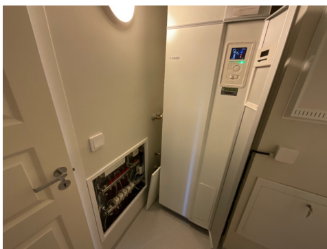
Avtrekksvarmepumpe og gulvvarmeskap
