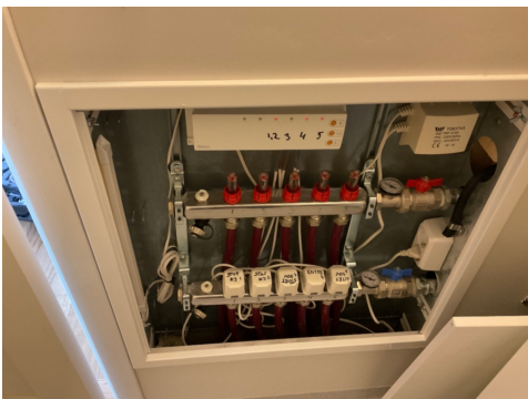
Skap for fordeling av gulvvarmeanlegg plassert boden.
