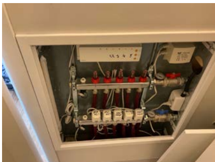
Skap for fordeling av gulvvarmeanlegg plassert boden.
