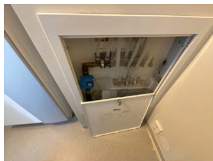
Rør i rør skap, Tappevann
