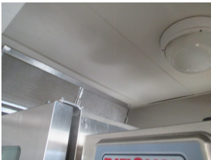
Avtrekk over steikeovner
