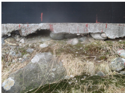
Masser har glidd ut under enkelt tilbygg i første etasje.
