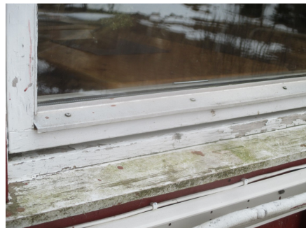
Trenger utvendig vedlikehold.
