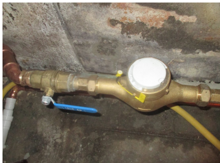
Innvendig hovedstoppekran med vannmåler i pumperom.
