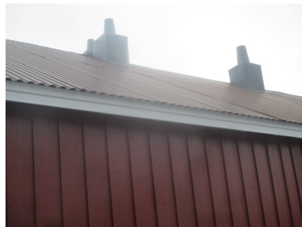
Mangler takrenner på baksiden av deler av bygget
