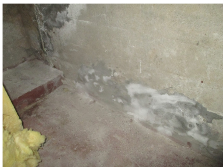
Noe salutslag og fuktvandring på verksted/lagerrom.
