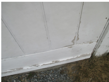
Utvendig svelling på ene ytterdøren.
