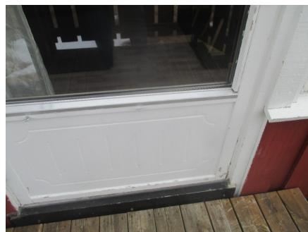
Slitt balkongdør i stue.
