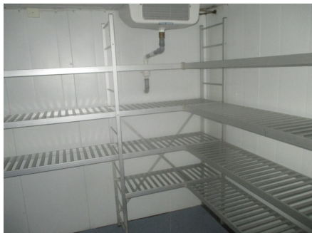
Deler av kjølerommet.
