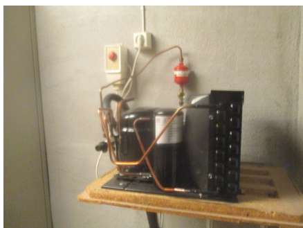
Aggregatet er plassert på teknisk rom.
