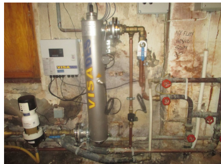
Teknisk opplegg i pumperom i kjeller.
