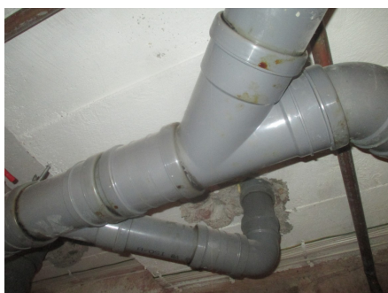
Deler av avløpsrør i pumperom i kjeller
