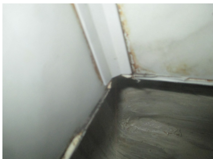
Skader på våtromsplater i dusjnise
