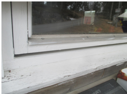
Noe slitasje på utvendig karm og ramme.
