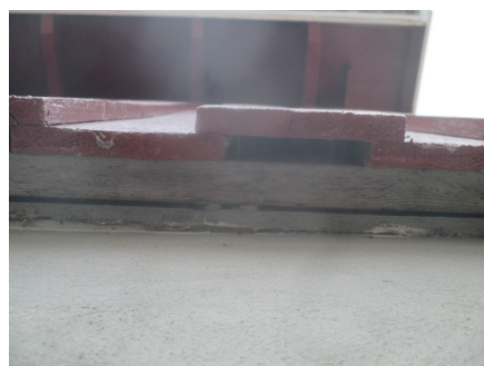
Ingen synlig musesikkring i mot grunnmur
