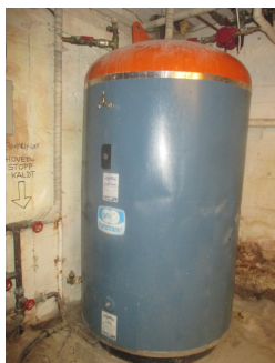
Stor eldre bereder i pumperom i kjeller
