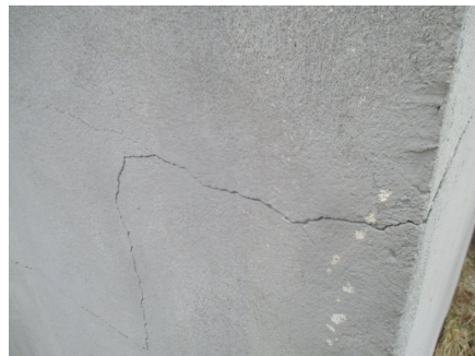
Noen sprekker på ene ytterhjørne av tilbygget del.
