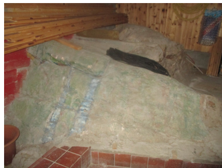
Deler av fjell kommer inn i pumperom.
