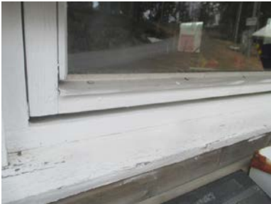
Noe slitasje på utvendig karm og ramme.
