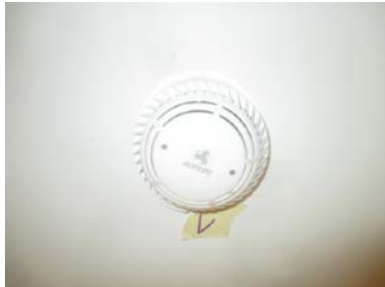
Røykvarslere i alle rom
