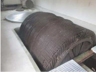
Renseanlegg i en egen bygning.
