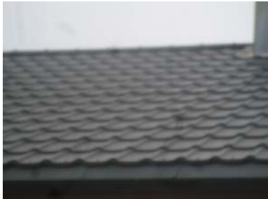
Deler av tekking over tilbygget deler.
