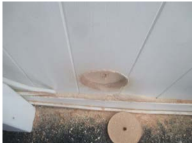
Hulltaking er foretatt i utfored vegg på soverom 004.
