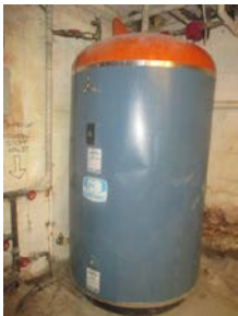
Stor eldre bereder i pumperom i kjeller
