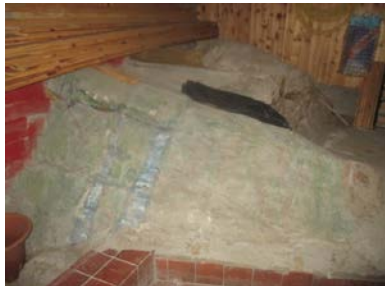
Deler av fjell kommer inn i pumperom.
