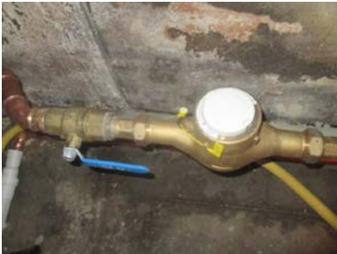
Innvendig hovedstoppekran med vannmåler i pumperom.
