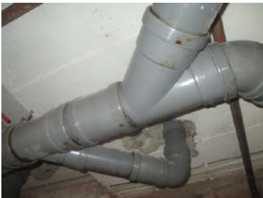
Deler av avløpsrør i pumperom i kjeller
