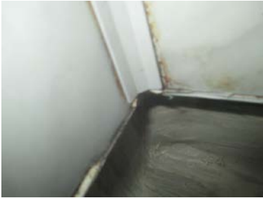
Skader på våtromsplater i dusjnise
