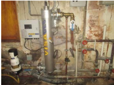
Teknisk opplegg i pumperom i kjeller.
