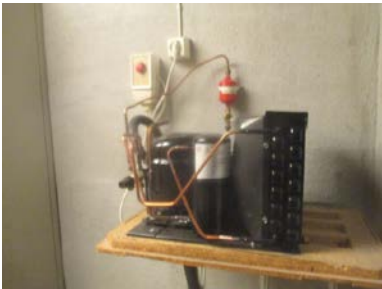
Aggregatet er plassert på teknisk rom.
