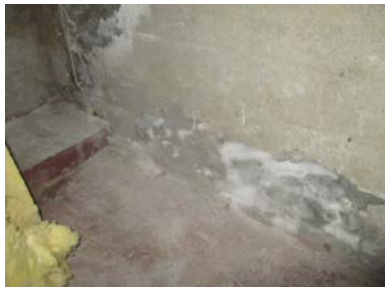
Noe salutslag og fuktvandring på verksted/lagerrom.
