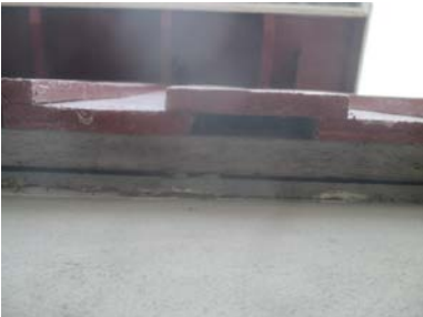
Ingen synlig musesikkring i mot grunnmur
