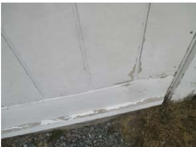
Utvendig svelling på ene ytterdøren.
