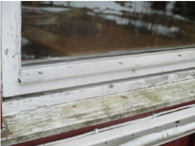
Trenger utvendig vedlikehold.
