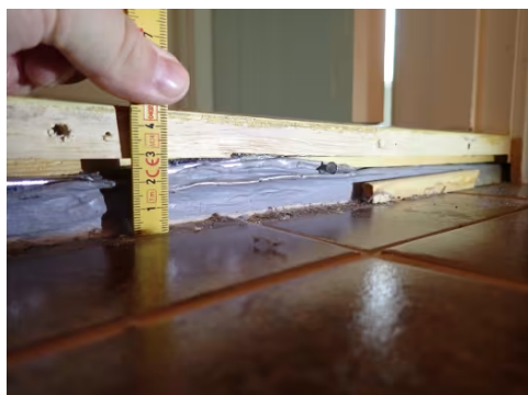
God høyde på membran under dørterskel.
