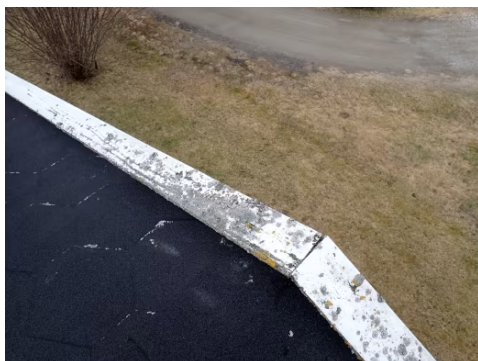
Slitasje i vannbord
