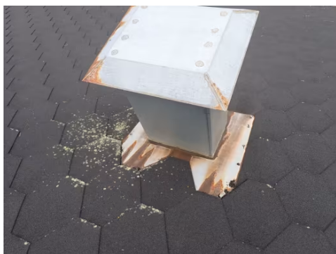
Rustdannelse i beslag
