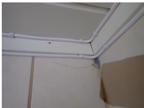
Sprekk i flis.
