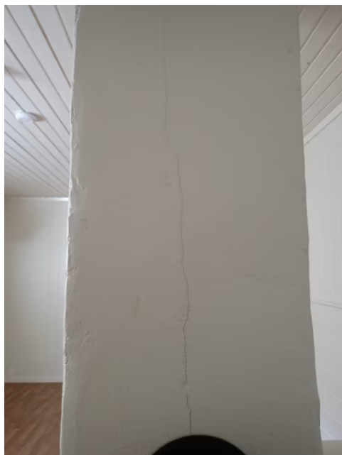
Riss/sprekk i pipe
