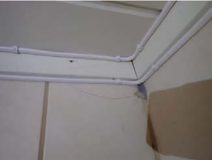
Sprekk i flis.
