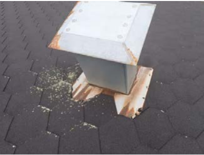
Rustdannelse i beslag
