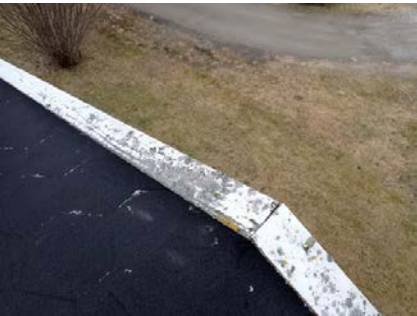
Slitasje i vannbord
