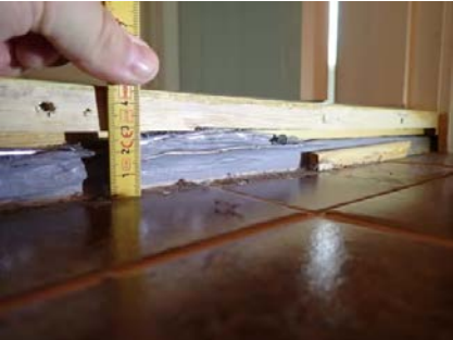
God høyde på membran under dørterskel.
