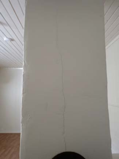
Riss/sprekk i pipe
