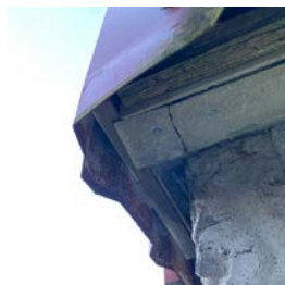
Fukt og råte i lekt
