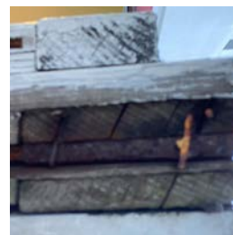
Rust i låsemekanisme under vindu.
