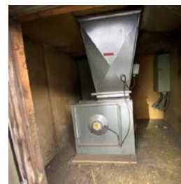
Felles avtrekksvifte på tak
