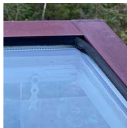
Løs utvendig gummipakning kan føre til vanninntrengning.
