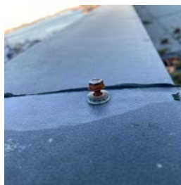
Løse skruer i gesimsbeslaget
