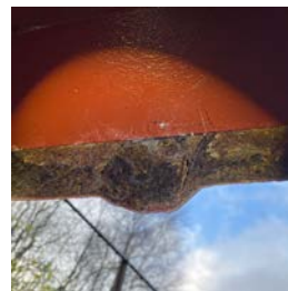
Rust på fasadeplater
