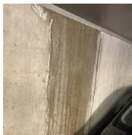
Lekkasjer i garasje ved blokk D
