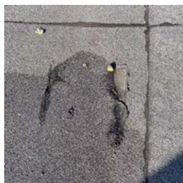
Skade i belegg
