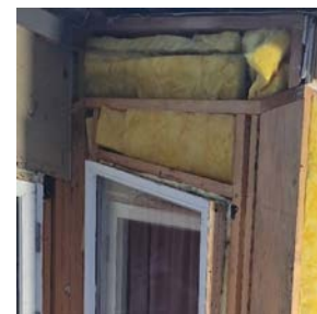
Bildet viser avdekking av dårlig isolert vegg ved demontering av vindsperreplater.
