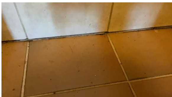
Mykfug i overgang gulv/vegg er i oppløsning.
