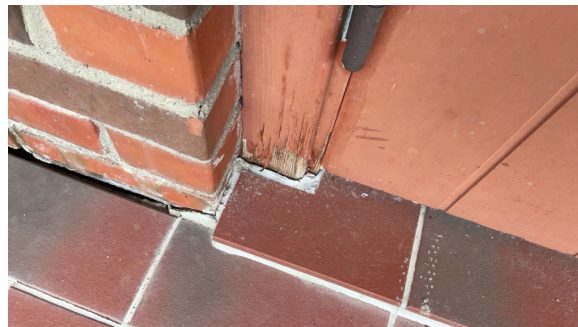
Det er påvist avvik rundt innsettsdetaljer.
