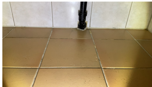
Utilfredstillende tetting ved rørgjennomganger
