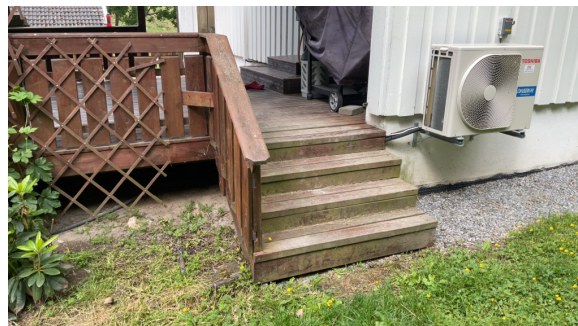
Det mangler rekkverk i trapp.
