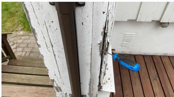
Det er påvist spredte råteskader i bordkledningen.
