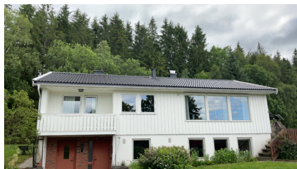
Det mangler snøfangere på hele eller deler av taket.
