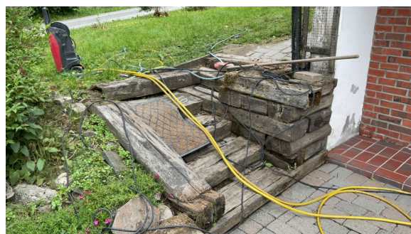
Det er påvist råteskader i konstruksjonen.
