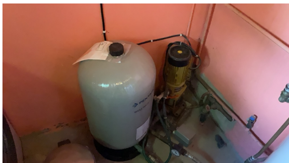
Vannpumpe og trykktank.
