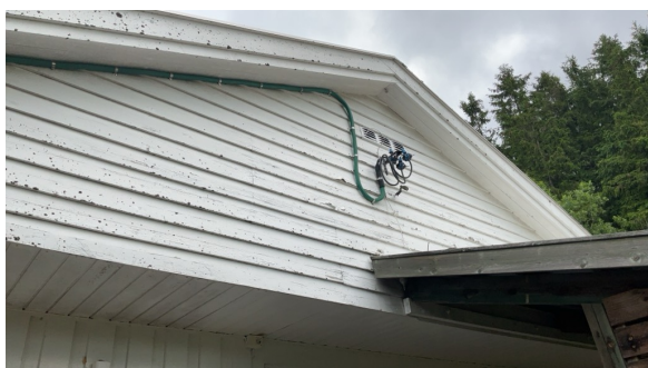
Fasader har behov for vask og overflatebehandling.
