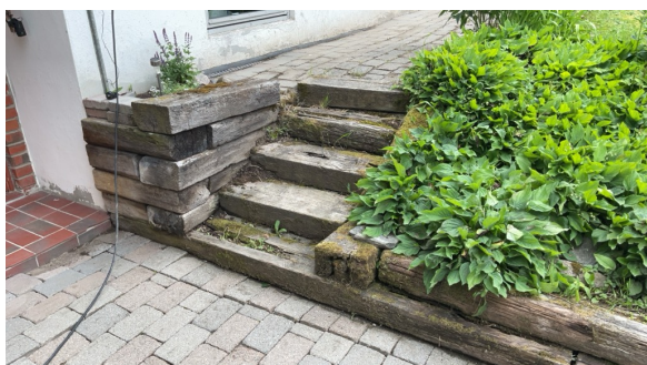
Det er påvist råteskader i konstruksjonen.
