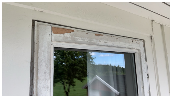
Balkongdør på soverom har behov for vedlikehold
