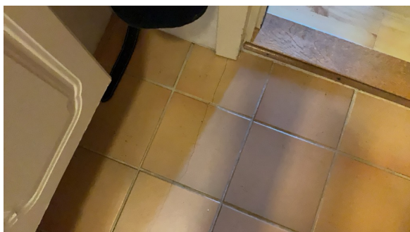
Det er påvist sprekker i fliser.
