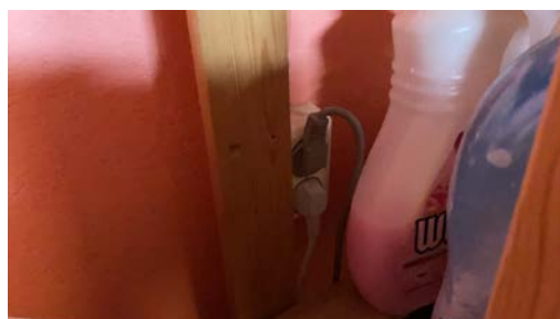
Det er ikke påvist tilfredsstillende el-tilkobling av varmtvannstank iht. gjeldende forskrift.
