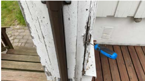
Det er påvist spredte råteskader i bordkledningen.
