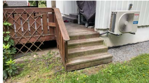
Det mangler rekkverk i trapp.
