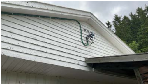
Fasader har behov for vask og overflatebehandling.
