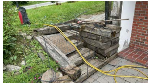
Det er påvist råteskader i konstruksjonen.
