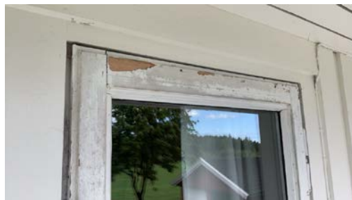
Balkongdør på soverom har behov for vedlikehold
