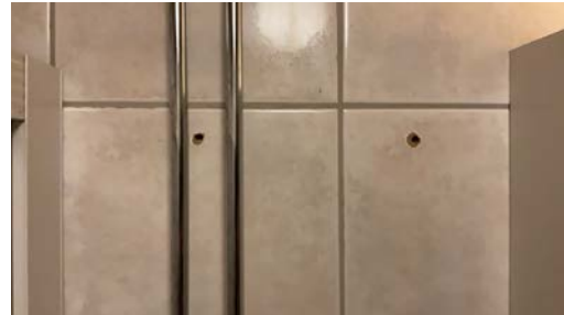
Hull i vegg bør tettes
