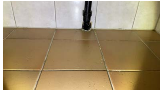
Utilfredstillende tetting ved rørgjennomganger
