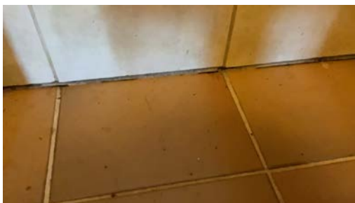
Mykfug i overgang gulv/vegg er i oppløsning.
