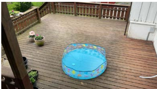
Det er etterslep på vedlikehold av overflater.
