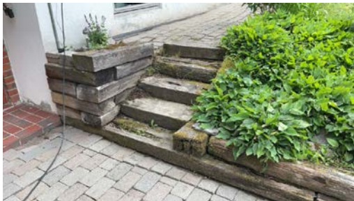
Det er påvist råteskader i konstruksjonen.
