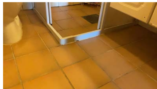
Det er mulighet for at det kan forekomme vannlekkasje på våtrommet hvor vann ikke vil gå til sluk.
