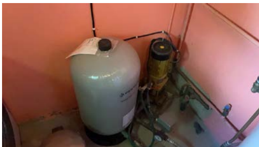
Vannpumpe og trykktank.
