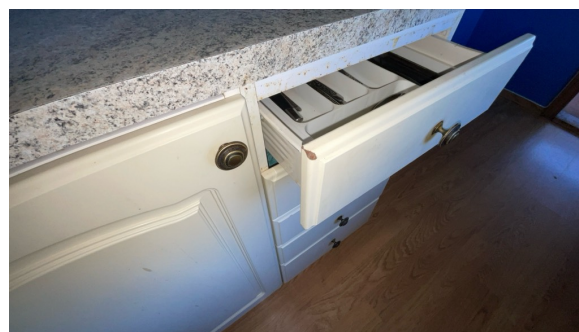
Skade på enkelte kanter på innredningen.
