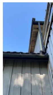
Ingen synlig ventilering i raftekasser
