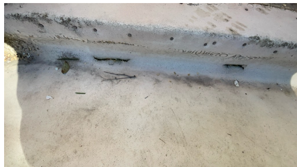
Skade i belegg på verandadekke i 2. etasje
