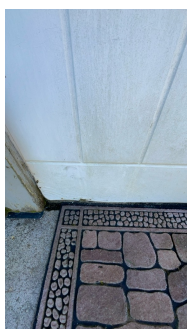
Svelleskade og overflateslitasje på hoveddør
