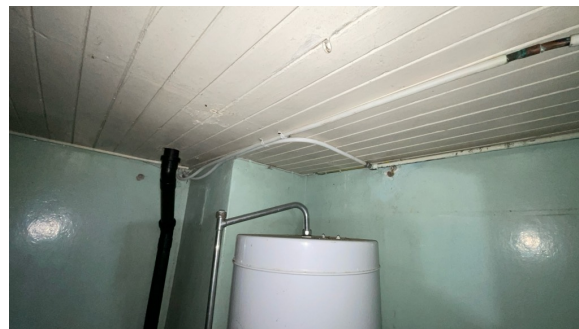
Åpne rør i kald kjeller
