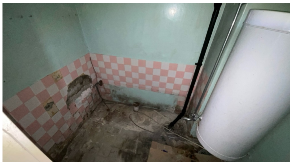
Synlige skader på tidligere bad
