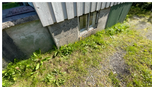
Ingen synlig grunnmursplast
