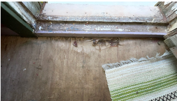
Skade på gulv ved verandadør på loft
