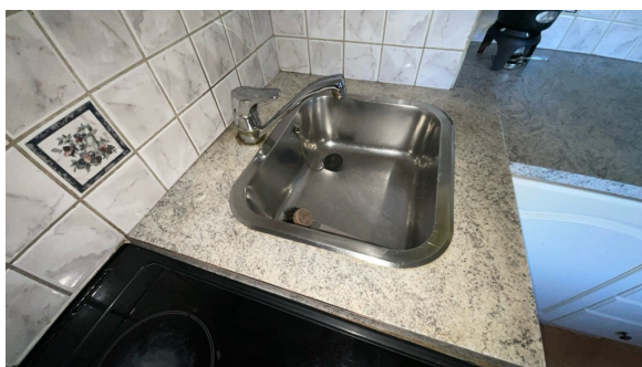
Svelleskade på benkeplate ved vask
