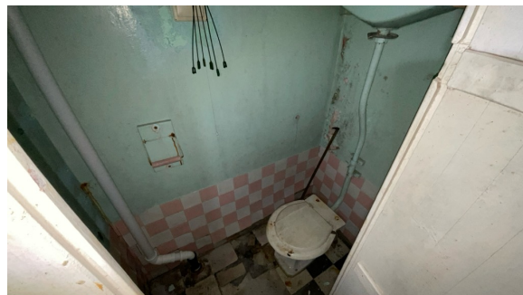
Synlige skader på tidligere toalettrom
