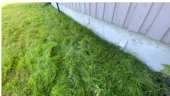
Ingen synlig grunnmursplast
