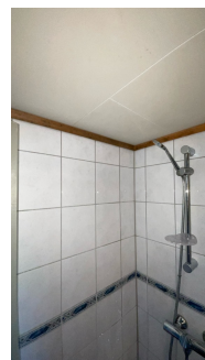
Misfarging på taklist over dusj som følge av redusert ventilasjon.
