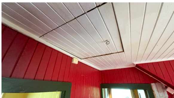
Uisolert loftsluke på gang
