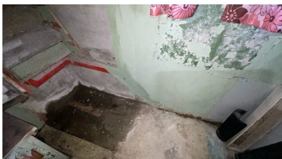
Synlig fukt på teknisk rom
