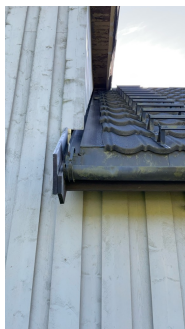
Mangler beslag på vindskibord mot veien på begge sider av oppløft
