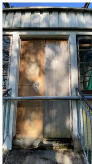
Hoveddør inngang på forsiden av boligen med råte
