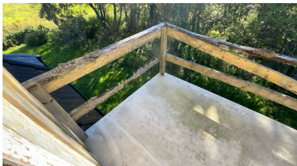
Råte i rekkverk
