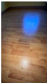
Svelleskade på laminatgulv, soverom på loft.
