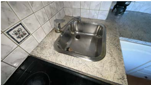
Svelleskade på benkeplate ved vask
