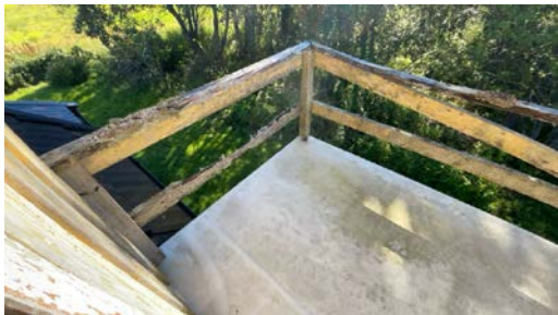
Råte i rekkverk
