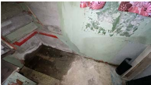
Synlig fukt på teknisk rom
