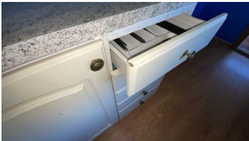
Skade på enkelte kanter på innredningen.
