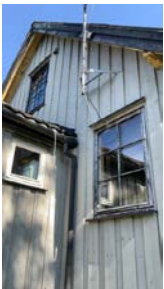
Vindu på stue 1 og på soverom loft. Vindu på loft er punktert
