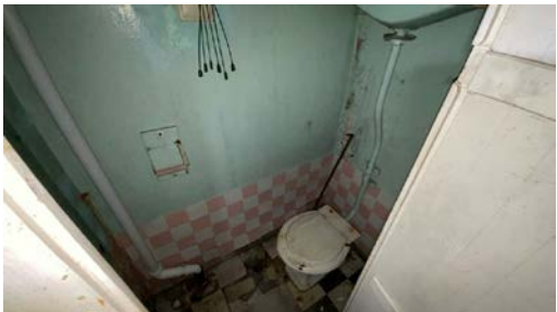
Synlige skader på tidligere toalettrom
