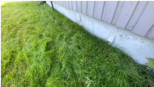
Ingen synlig grunnmursplast
