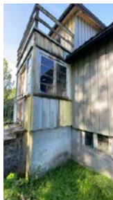
Vinduer i tilbygg er hensyntatt å byttes ifb. pkt balkong grunnet råte
