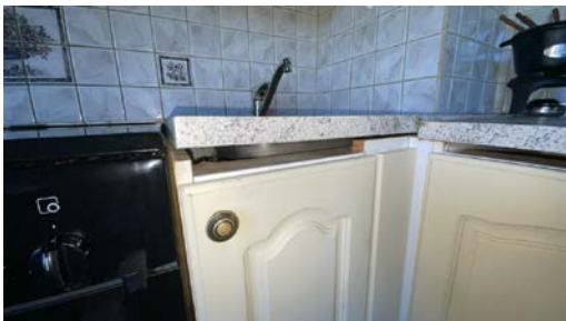
Det mangler foringslist under benkeplate
