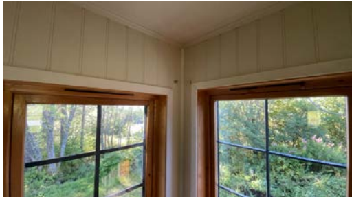
Det er ikke montert innvendige ventil rister på alle vinduer
