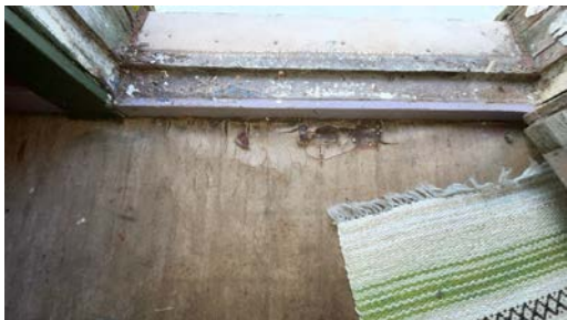
Skade på gulv ved verandadør på loft
