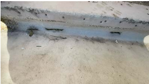
Skade i belegg på verandadekke i 2. etasje
