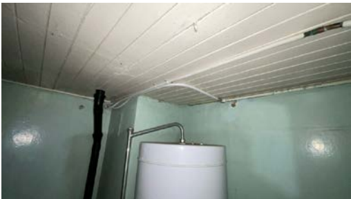
Åpne rør i kald kjeller
