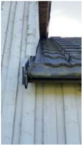
Mangler beslag på vindskibord mot veien på begge sider av oppløft
