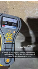
Kontroll av sponplate i himling på lagerrum 1 mot bakvegg. Det er synlig hvitt mugg på plater. Fuktmåling viser 23,6%
