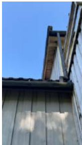
Ingen synlig ventilering i raftekasser
