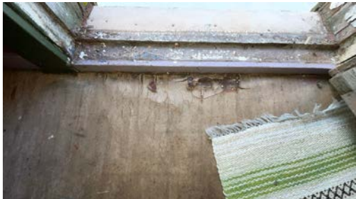
Skade på gulv ved verandadør på loft
