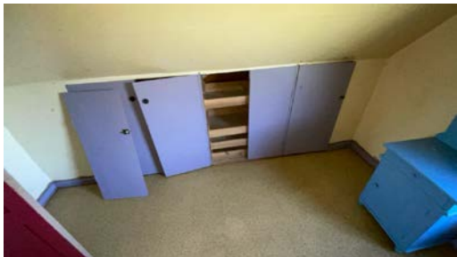
Skapdør på innebygd skap oppe på loft er falt av. Overflater på rommet er slitt
