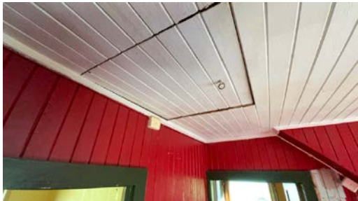
Uisolert loftsluke på gang
