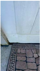
Svelleskade og overflateslitasje på hoveddør
