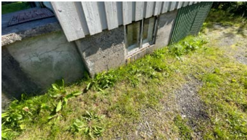
Ingen synlig grunnmursplast
