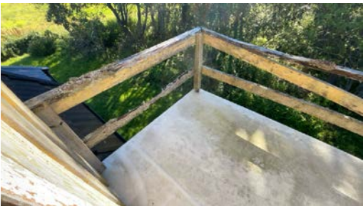
Råte i rekkverk
