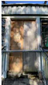
Hoveddør inngang på forsiden av boligen med råte
