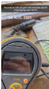
Kontroll av fukt på gulv ved verandadør på loft. Fuktmåling viser 66,8%
