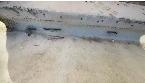
Skade i belegg på verandadekke i 2. etasje
