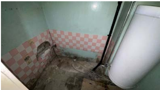
Synlige skader på tidligere bad
