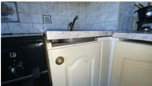
Det mangler foringslist under benkeplate
