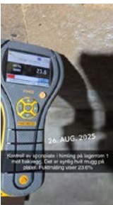
Kontroll av sponplate i himling på lagerrom 1 mot bakvegg. Det er synlig hvitt mugg på plater. Fuktmåling viser 23,6%
