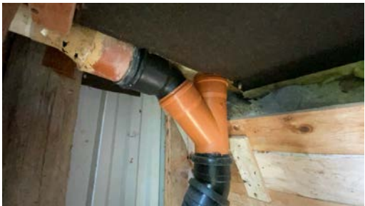
Åpen isolasjon i krypkjeller
