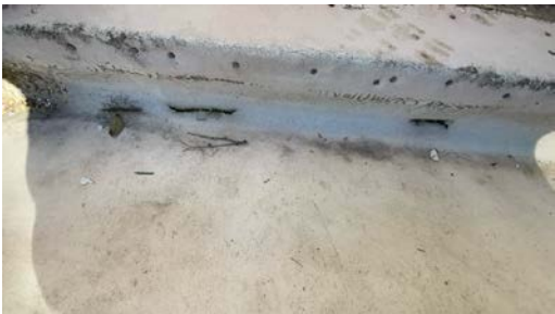
Skade i belegg på verandadekke i 2. etasje
