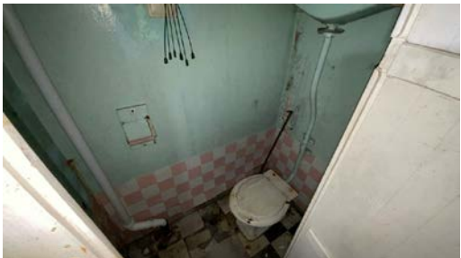
Synlige skader på tidligere toalettrom
