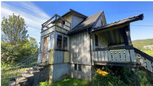
Eldre værslitt kledning ved tilbygg. Kostand for bytte er hensyntatt i pkt. balkong
