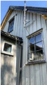
Vindu på stue 1 og på soverom loft. Vindu på loft er punktert
