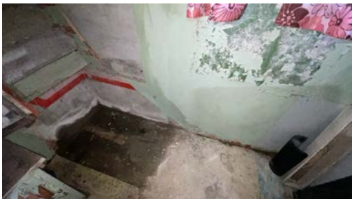
Synlig fukt på teknisk rom
