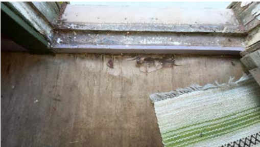
Skade på gulv ved verandadør på loft
