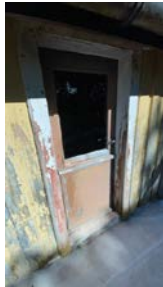
Innadslående dør ut til veranda i 2. etasje.
