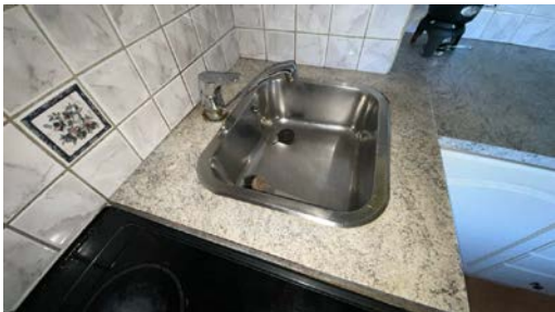
Svelleskade på benkeplate ved vask
