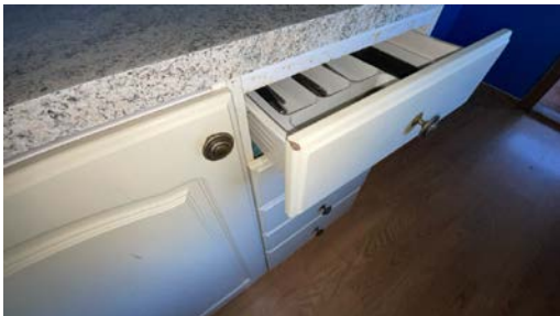
Skade på enkelte kanter på innredningen.
