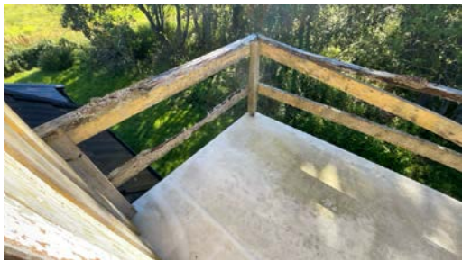
Råte i rekkverk
