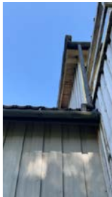
Ingen synlig ventilering i raftekasser
