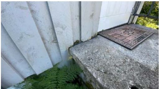
Råte i bord ved hoveddør mot trapp. Bør utbedres og bakenforliggende konstruksjon kontrolleres
