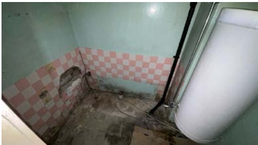
Synlige skader på tidligere bad
