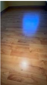
Svelleskade på laminatgulv, soverom på loft.
