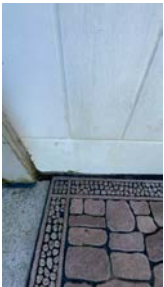
Svelleskade og overflateslitasje på hoveddør
