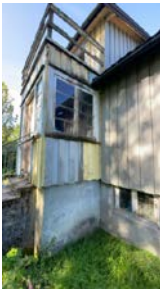
Vinduer i tilbygg er hensyntatt å byttes ifb. pkt balkong grunnet råte
