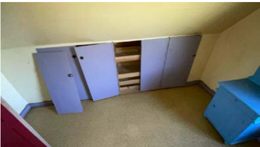
Skapdør på innebygd skap oppe på loft er falt av. Overflater på rommet er slitt
