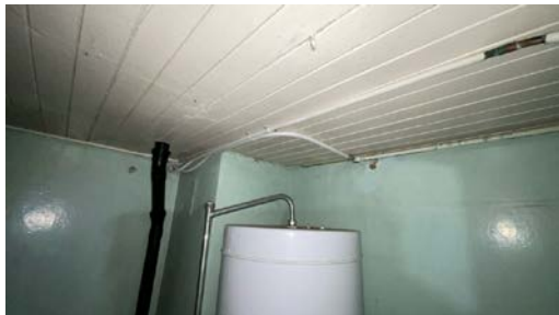
Åpne rør i kald kjeller
