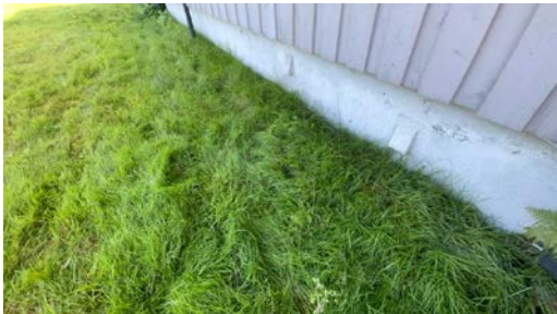
Ingen synlig grunnmursplast
