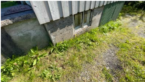
Ingen synlig grunnmursplast
