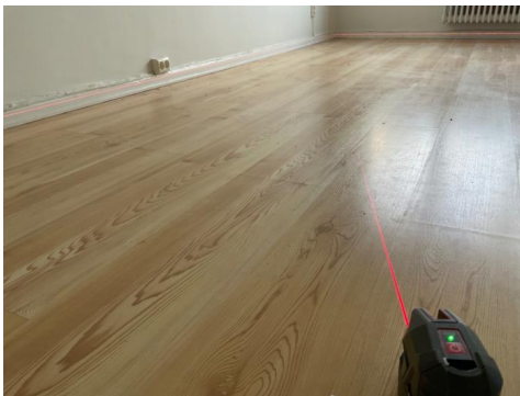
Nivellering stue/kjøkken, avvik ca. 10-20 mm
