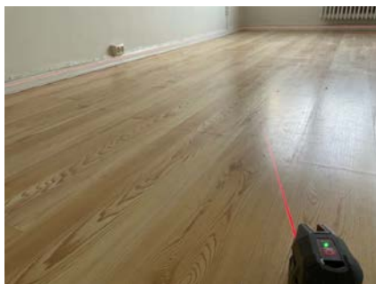
Nivellering stue/kjøkken, avvik ca. 10-20 mm
