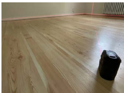
Nivellering soverom, avvik ca. 10-20 mm
