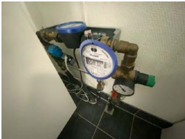
Hovedstoppekran med vannmåler på tolaetrom. Etablert vannstopper med føler.
