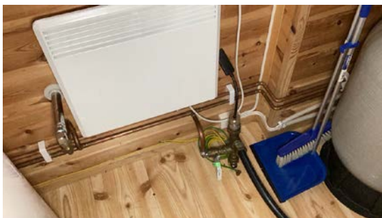
Vannrør ligger mot yttervegg.
