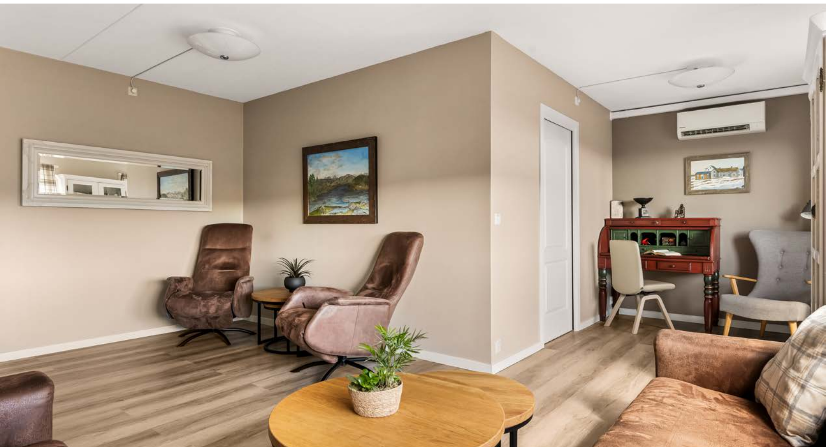
Varmepumpe er plassert i stuen og bidrar til et behagelig og energieffektivt inneklima året rundt.
