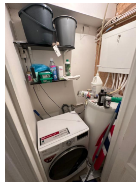
Teknisk rom med vaskemaskin og bereder
