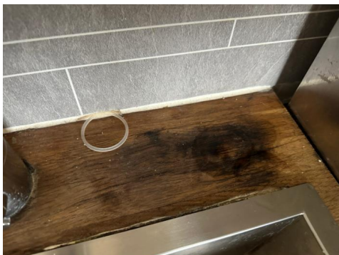
Brukslittasje på benkeplate v/kum
