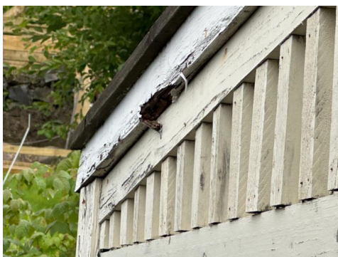
Råte i vindski på takoverbygg på terrasse
