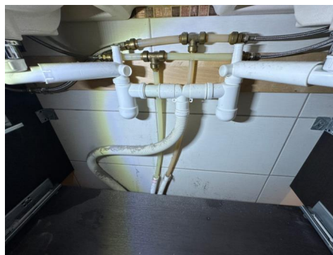
Rørpropplegg i servantskap
