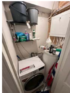
Teknisk rom med vaskemaskin og bereder
