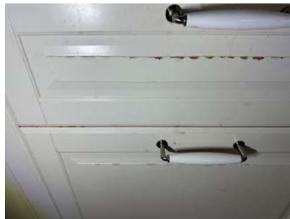
Brukslitasje på en front ved kum
