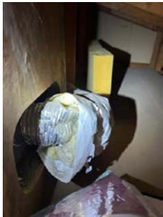
Avtrekkskanal til bad fra loft er noe sammenpresset på loftet
