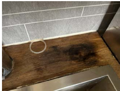
Brukslitasje på benkeplate v/kum
