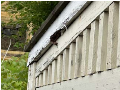
Råte i vindski på takoverbygg på terrasse
