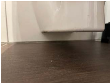
Ingen åpning for lekkasjevann under wc UNDERETASJE > BAD
