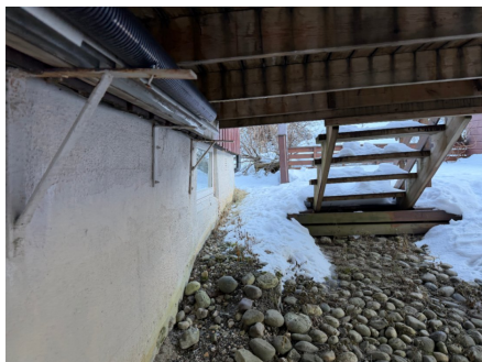
Garasje vegg er presset inn 5-6 cm (jordtrykk).
