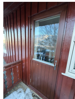
Balkongdør tetter dårlig mellom dørbblad og karm.
