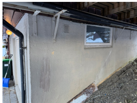
Horisontale riss og skråriss.
