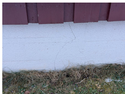
Sprekker i mur mot nordvest.
