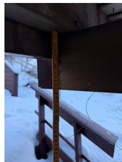
Målt 20 cm ved pillar. Total skjevhet på ca. 7 cm.
