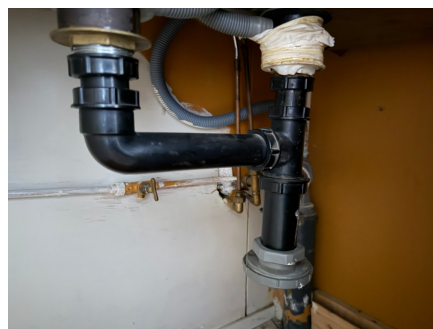
Rørkoblinger er tapet.
