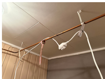
Tanken er tilkoblet via skjøteledning.
