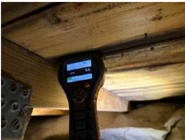
Gamle fuktmerker i tro. Måling er utført med Protimeter MMS 2, korrigert for nordisk tre. Målt 9,4v% som er tørt.
