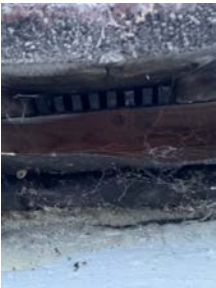
Musebånd i nedre del av kledning.
