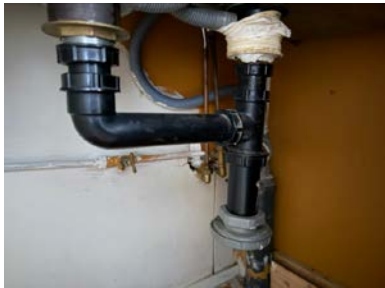
Rørkoblinger er tapet.
