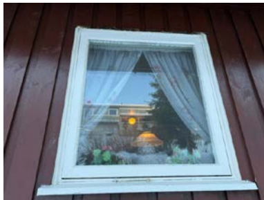
Koblet vindu. Utvendige omrammingsbord på vinduer er stedvis satt helt ned på beslag, skadeutsatt løsning med fuktopptrekk og påfølgende råteskader.
