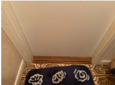
ingne tilluft under dør
