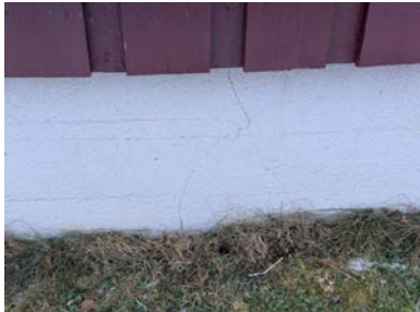
Sprekker i mur mot nordvest.
