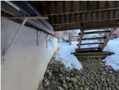
Garasje vegg er presset inn 5-6 cm (jordtrykk).
