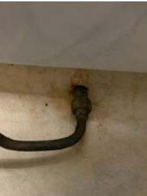
Gjennomføringer av vannrør er ikke tettet i våtsone.
