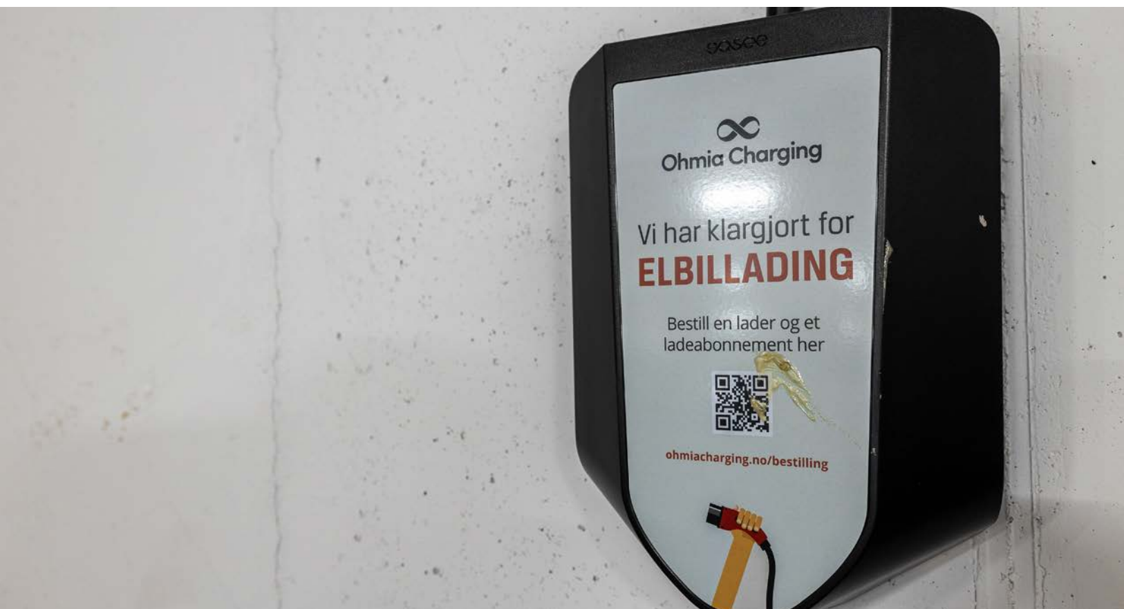
På garasjeplassen er det klargjort for el-bil lading med lader fra Easee.
