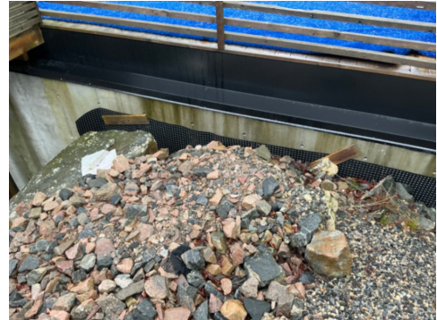
Mangler topplist på sort grunnmursplast.
