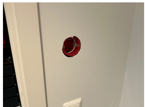
Mangler et blendelokk på bad nede.
