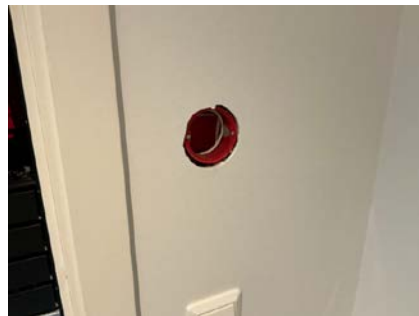
Mangler et blendelukk på bad nede.
