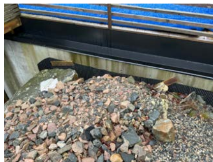
Mangler topplist på sort grunnmursplast.
