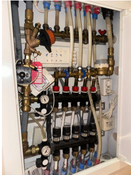
Samleskap med rørkurser og stoppekraner
