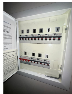
Sikringsskap med automatsikringer.
