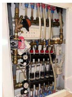
Samleskap med rørkurser og stoppekraner
