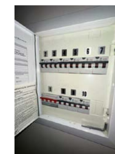
Sikringsskap med automatsikringer.
