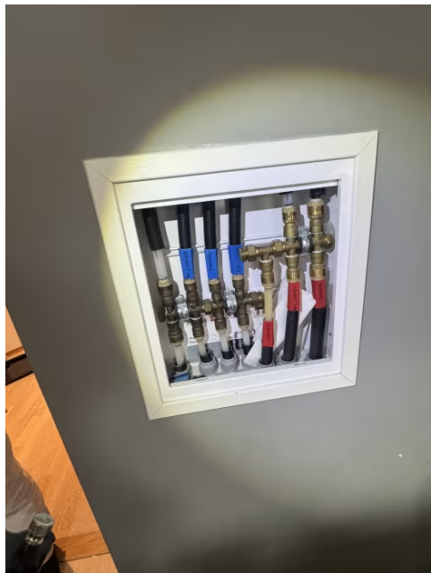
Fordelerskap på soverom i 2. etasje.
