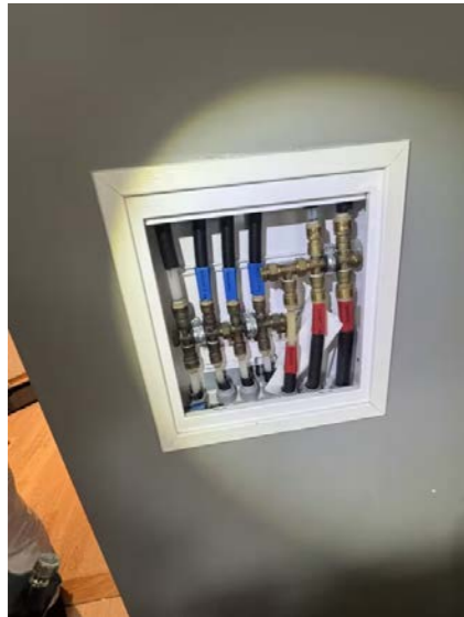
Fordelerskap på soverom i 2. etasje.
