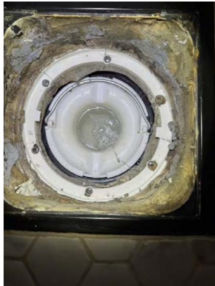
Sluk på bad i 2. etasje.
