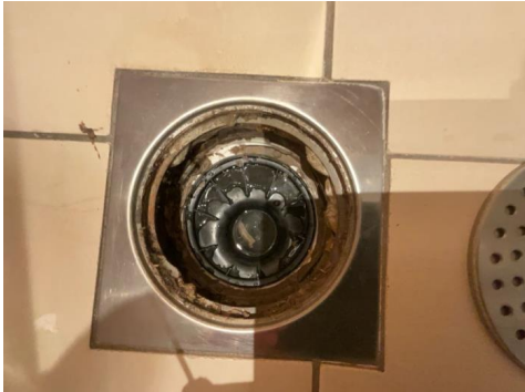
Plastsluk i dusjhjørne.
