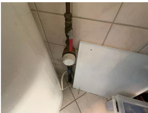
Stoppekran og vannmåler.
