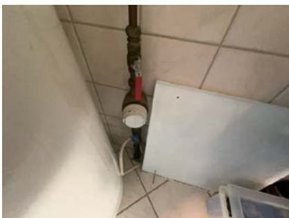
Stoppekran og vannmåler.
