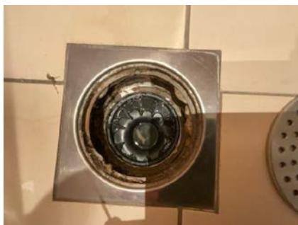
Plastsluk i dusjhjørne.
