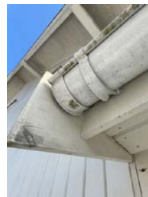
Drypplekkasje. Feilmontert endelokk.
