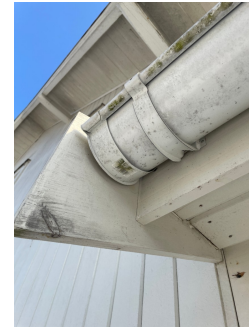
Drypplekkasje. Feilmontert endelokk.
