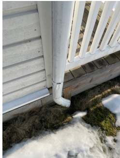
Manglende bortledning av vann.
