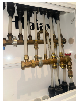
Samleskap med rørkurser og stoppekraner
