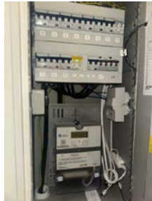
Sikringsskap med automatsikringer.
