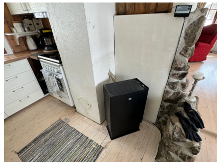
Pipe mot kjøkken har noe riss i murverk og krakelering på overflate.
