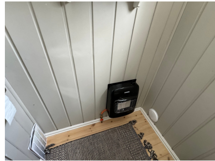
Gass ovn på toalett og bad
