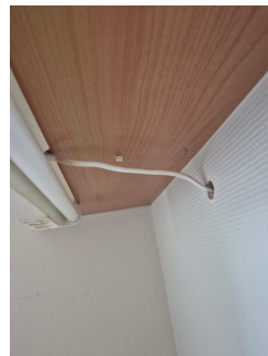
Ledning på kjøkken ikke tilstrekkelig festet.
