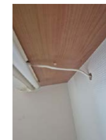
Ledning på kjøkken ikke tilstrekkelig festet.
