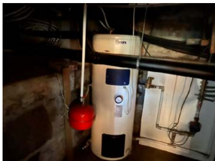
Teknisk anlegg i kjeller.
