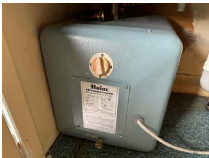
Eldre vvtank i kjøkkenbenk i 2 etasje.
