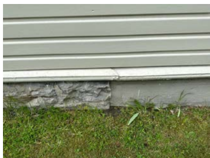
Ingen/lite lufting av kledning.
