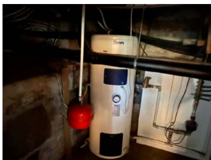
Vvtank/vannbåren varme i kjeller.
