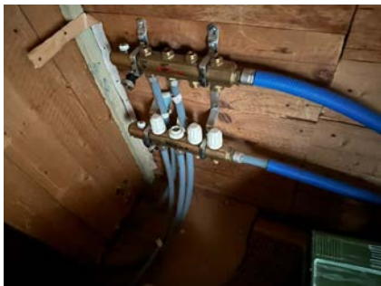
Vannrør i kott i 2 etasje.
