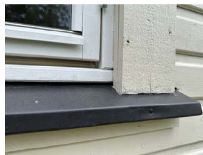
Manglende glipe mot vannbrett.
