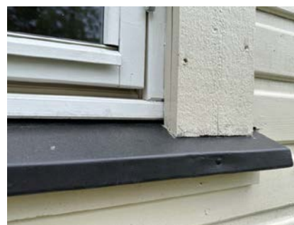
Manglende glipe mot vannbrett.
