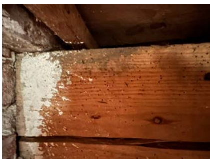
Spor etter treskadedyr i kjeller.
