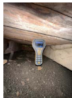
Fuktmåling i kjellerhimling/krypkjeller.
