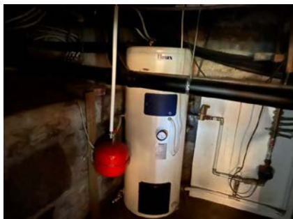
Teknisk anlegg i kjeller.
