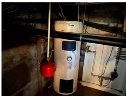
Vvtank/vannbåren varme i kjeller.
