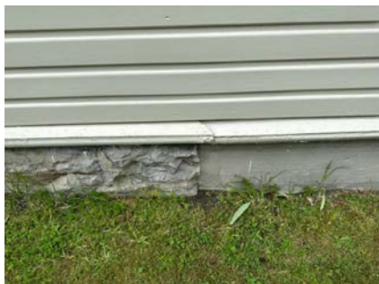
Ingen/lite lufting av kledning.
