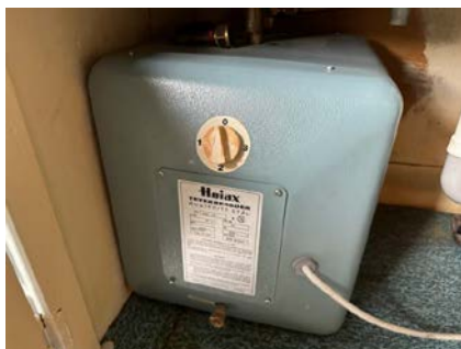
Eldre vvtank i kjøkkenbenk i 2 etasje.
