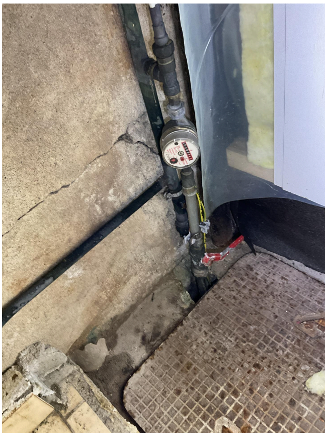
Vannmåler og stoppekran i kjellerbod
