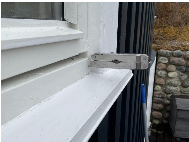
Finnes fuktpåkjente/råteskadet vinduer/dører
