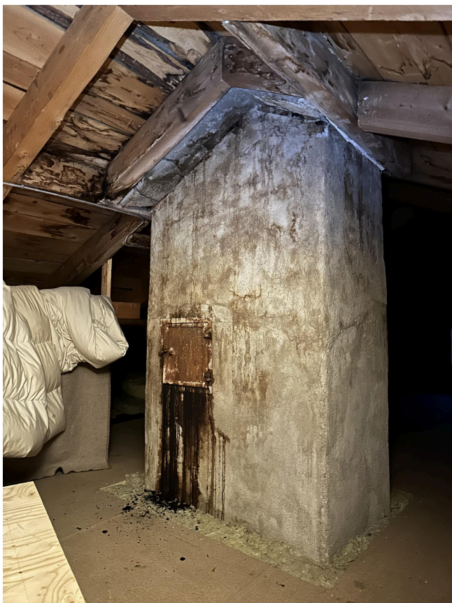
Feieluke på kaldloft med rust, med mye bekkstot under luke og flekkvis bekkstot. Mangler ubrennbart materiale under feieluken.
