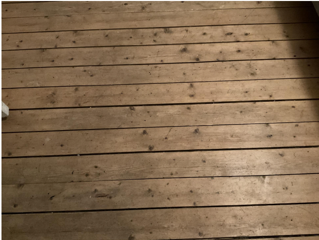
Store sprekker mellom gulvbord i 2. etasje
