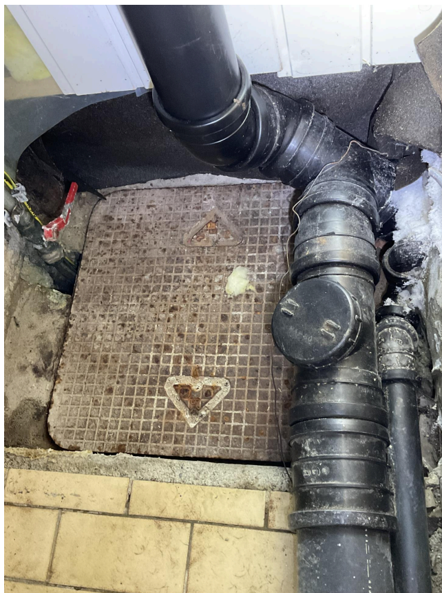
Plast avløpsrør i kjellerbod og stakeluke
