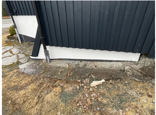
Nedløp satt ned i grunnavløp, men ikke funksjonstestet.
