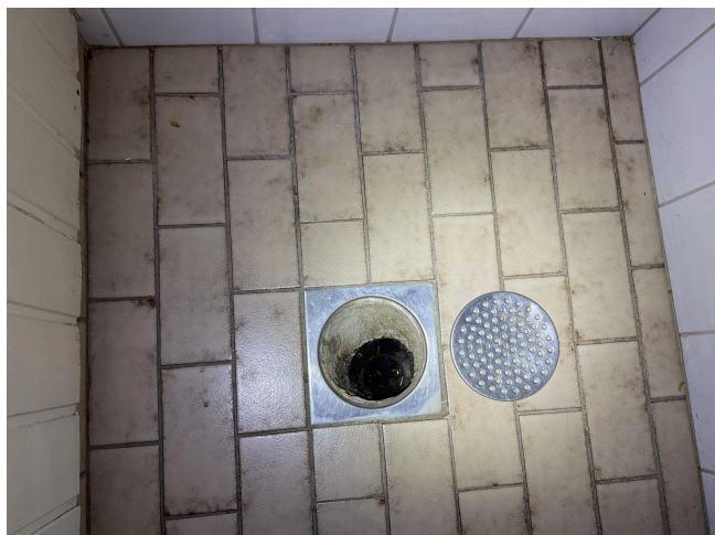
Plastsluk mangler membran lagt under klemmring. Malt panel/sokkelfliser er lagt i dusjsone/dusjnisje.
