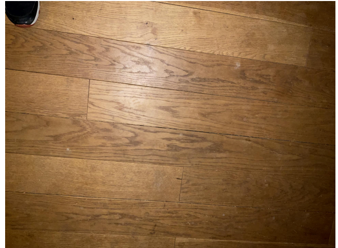
Parkettplanker 1 stav som har sprekker i skjøter.
