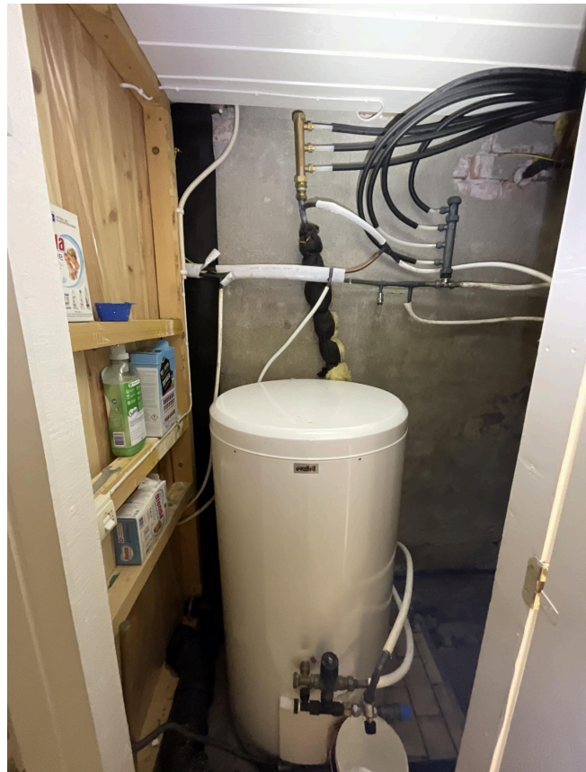
Plast rør i rør uten fordelskap i kjellerbod Varmtannsbereder ca 200 liter
