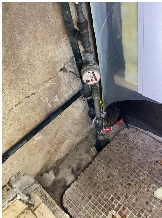
Synlige sprekker/setninger i bod ved bad i kjeller.
