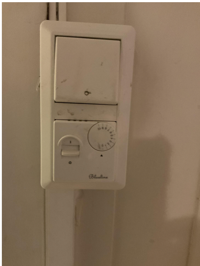
Varmekabler i gulv er termostatstyrt
