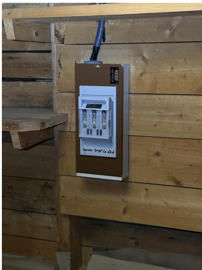
Hovedsikringer på kaldloft
