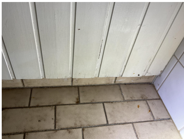
Fuktpåkjent/råte på malt/panel. Svertesopp på fliser.
