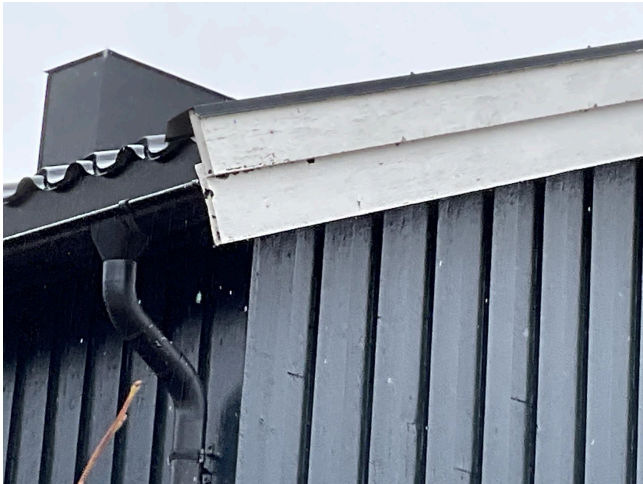
Takrenner/nedløp av stål
