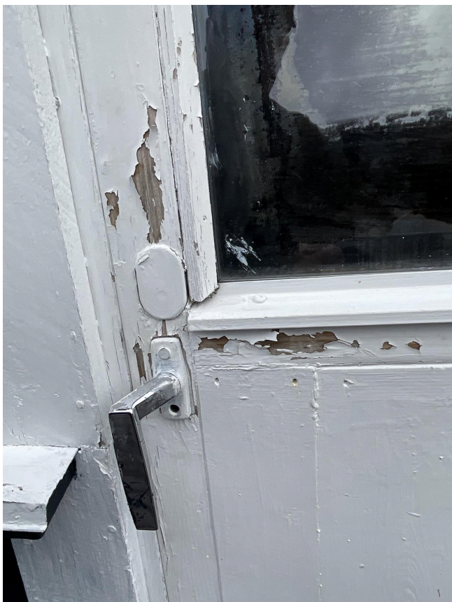
Tregt/skadet handtak på verandadør + råteskader/ punktert glass
