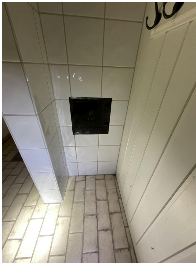
Feieluke på bad i kjeller
