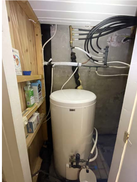
Plast rør i rør uten fordelskap i kjellerbod Varmtannsbereider ca 200 liter
