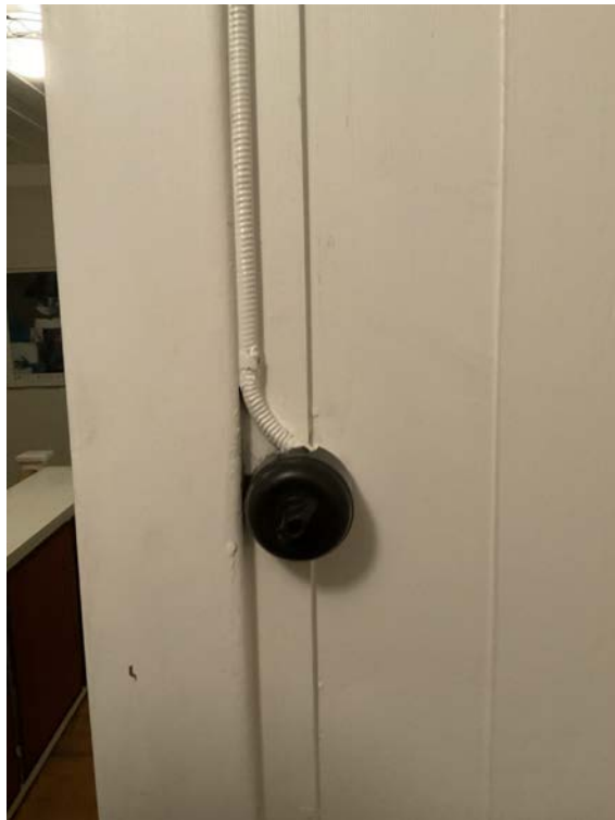
Det finnes enkelte eldre installasjoner
