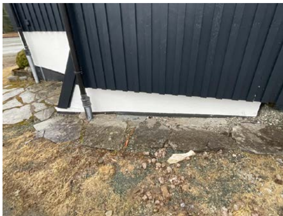
Nedløp satt ned i grunnavløp, men ikke funksjonstestet.
