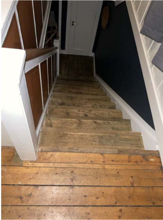
Trapp til 2.etg. av tre. Rekkverk er noe lavere enn dagens krav.
