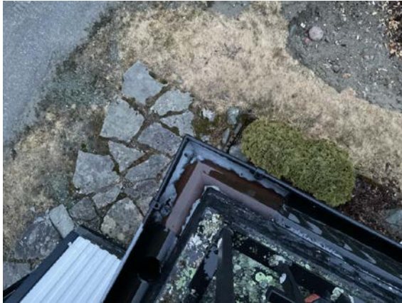
Registrert rust på malt sinkrenner avrenning til balkong
