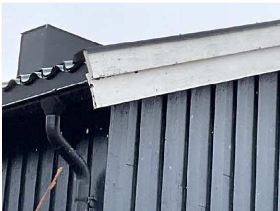
Takrenner/nedløp av stål
