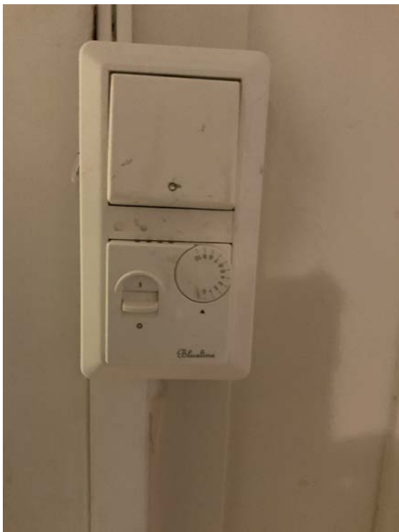
Varmekabler i gulv er termostatstyrt
