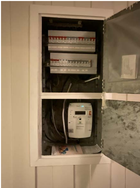
El-skap oppgradert med automatsikringer og måler i 2. etg. Hovedsikringer er på kaldloft
