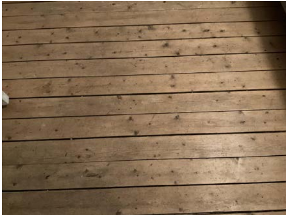
Store sprekker mellom gulvbord i 2. etasje
