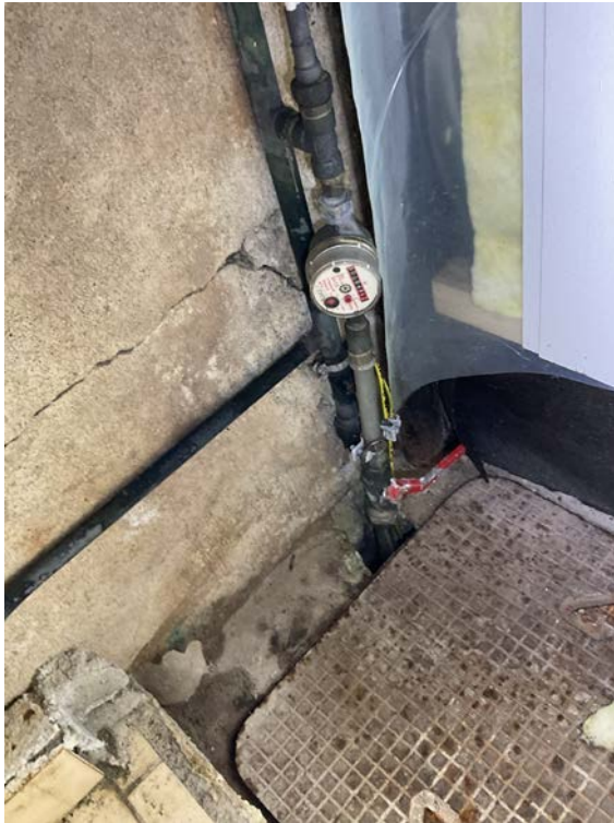
Vannmåler og stoppekran i kjellerbod
