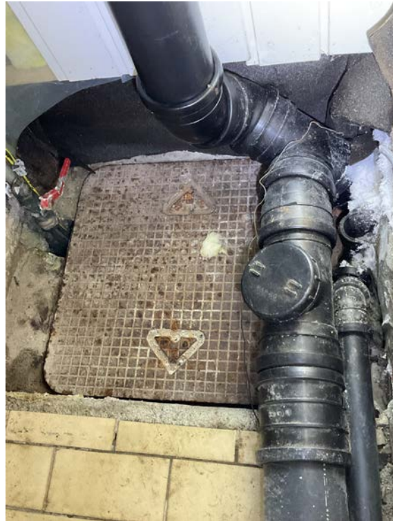
Plast avløpsrør i kjellerbod og stakeluke
