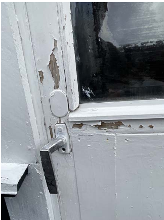
Tregt/skadet handtak på verandadør + råteskader/ punkttert glass
