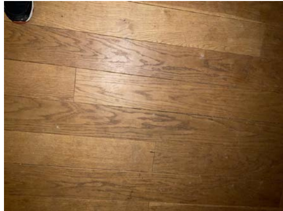
Parkettplanker 1 stav som har sprekker i skjøter.
