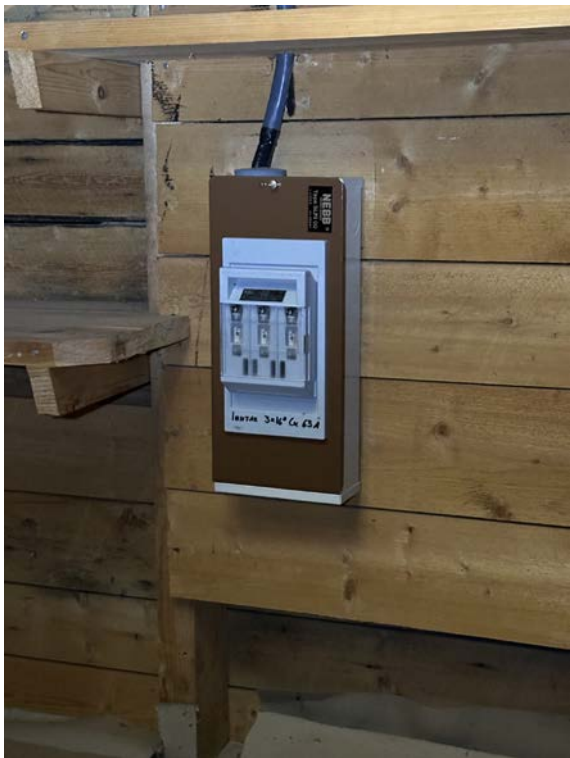
Hovedsikringer på kaldloft
