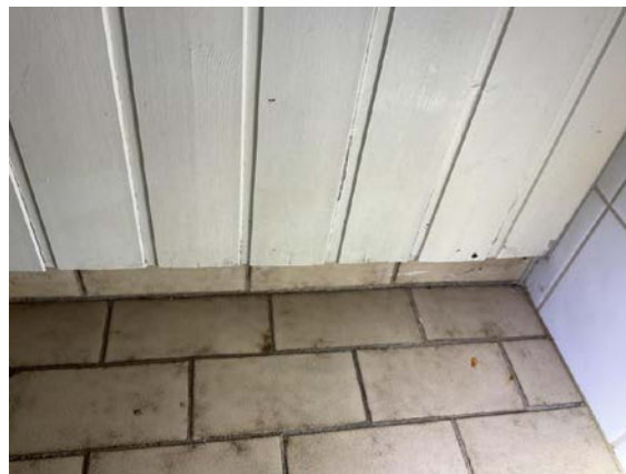
Fuktpåkjent/råte på malt/panel. Svertesopp på fliser.
