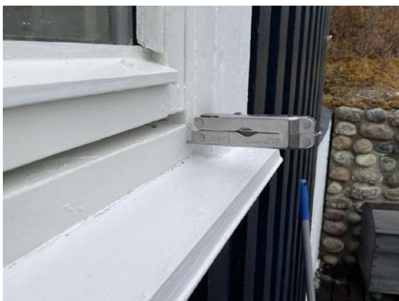
Finnes fuktpåkjente/råteskadet vinduer/dører
