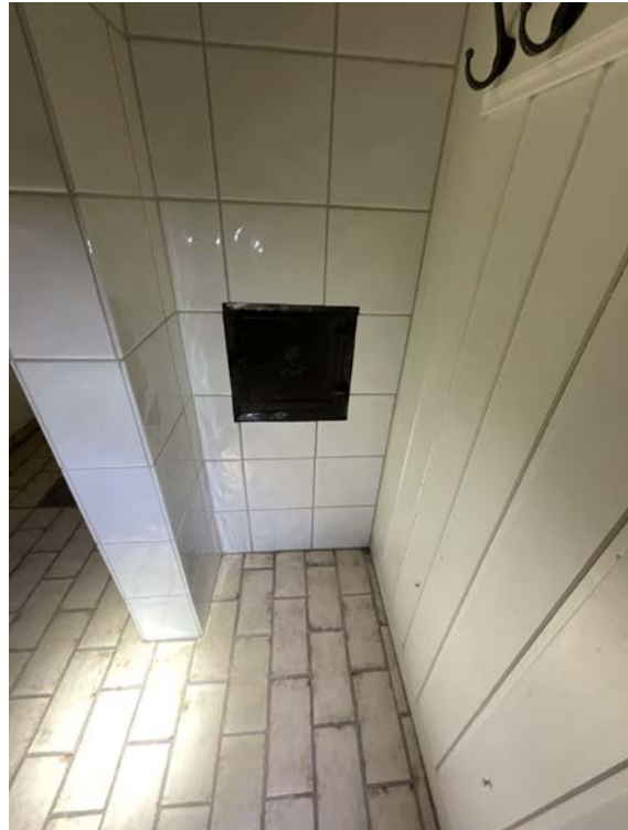
Feieluke på bad i kjeller
