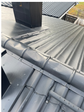
Takstige mangler helt bort til pipe.
