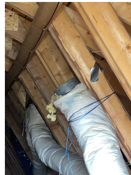
Åpne avtrekkskanal som ikke er tilkoblet.
