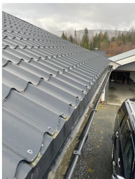
Taktekking mangler snøfangere
