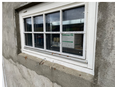
Sprekker i puss og ufaglig avslutning mot karm med fare for fukttinntrenging. Værslitte vinduskarmen utvendig.
