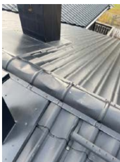
Takstige mangler helt bort til pipe.
