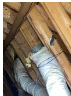
Åpne avtrekkskanal som ikke er tilkoblet.
