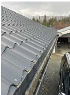
Taktekking mangler snøfangere
