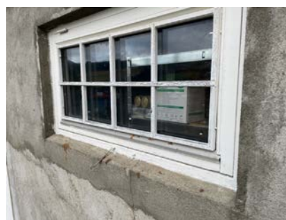
Sprekker i puss og ufaglig avslutning mot karm med fare for fukttinntrenging. Værslitte vinduskarmar utvendig.
