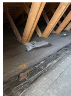
Loft. Ekskrementer fra mus synlig ved luke.
