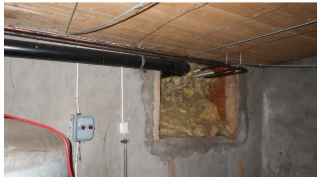
Plast avløpsrør fra bad.
