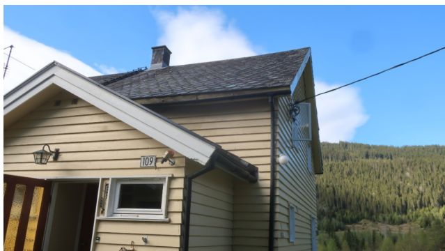
Takrennene er skadet av takras.
