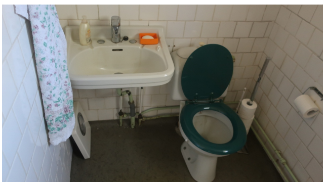
Åpent gammelt røranlegg.
