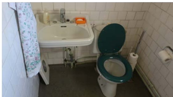
Åpent gammelt røranlegg.
