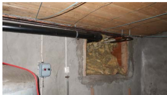
Plast avløpsrør fra bad.
