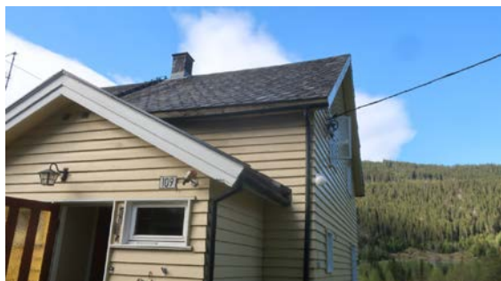
Takrennene er skadet av takras.
