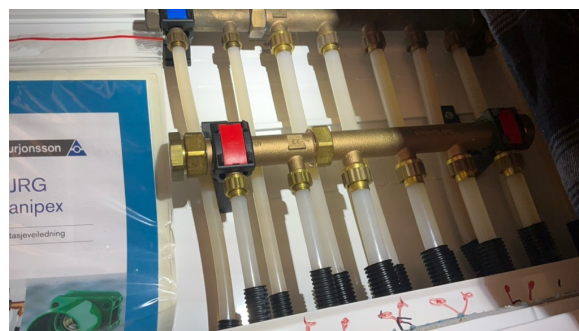
Fordelerskap på vaskerom. Utett fordelerskap.
