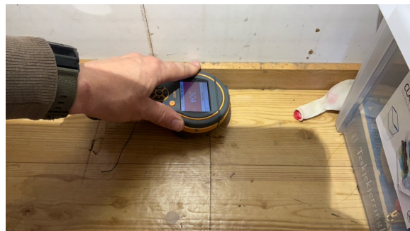
Enkle fuktsøk på gulv i bod viste forhøyde verdier.
