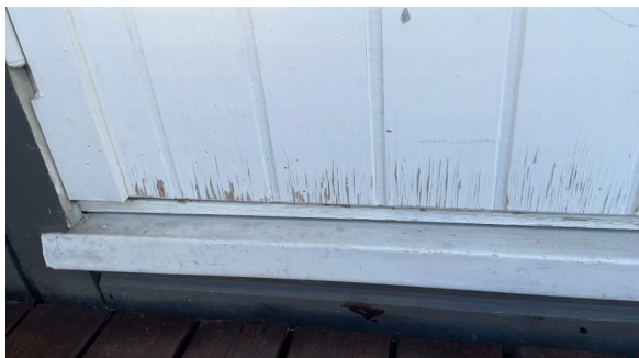
Verandadør bærer preg av slitasje.
