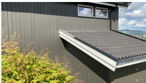
Manglende isbordsbeslag over bod.
