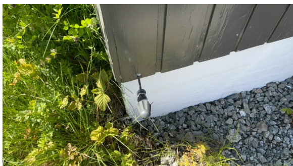
Råteskadet kledning registrert.
