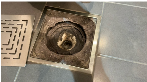
Kontroll av sluk, sluk er tilsmusset. Dette begrenser inspeksjonen.
