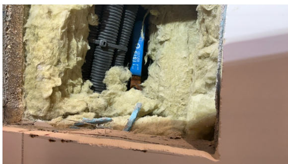
Stoppekran plassert i vaskerom. Eldre stoppekran.
