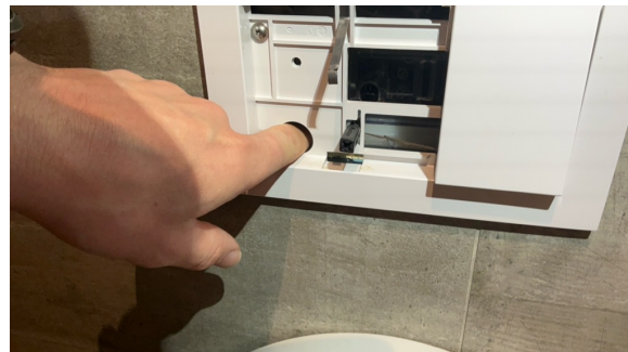
Indikasjoner på at sistene ikke er montert i henhold til monteringsveiledning.
