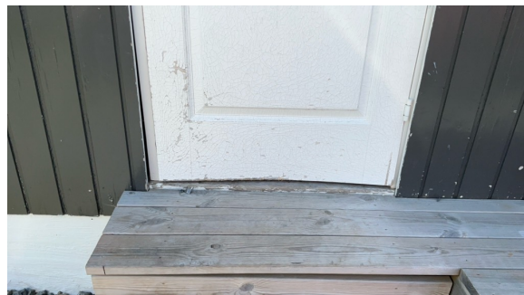
Dør til utvendig bod er defekt. Forholdet gis tilstandsgrad 3.
