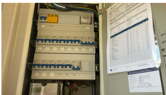
Sikringsskap i entréområdet.
