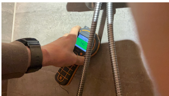
Enkle fuktsøk viste normale verdier.
