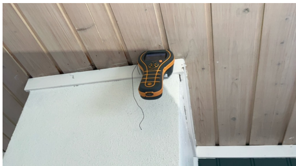
Fuktmerker rundt pipe. Enkel fuktmåling viste tørre verdier.
