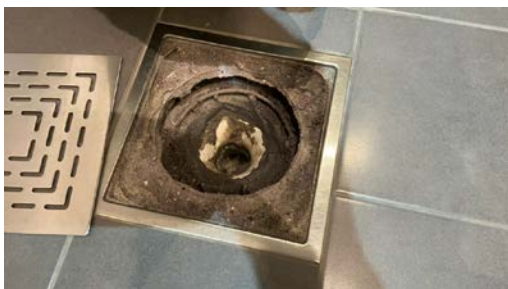
Kontroll av sluk, sluk er tilsmusset. Dette begrenser inspeksjonen.
