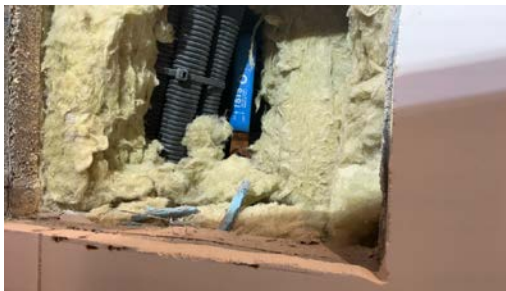
Stoppekran plassert i vaskerom. Eldre stoppekran.
