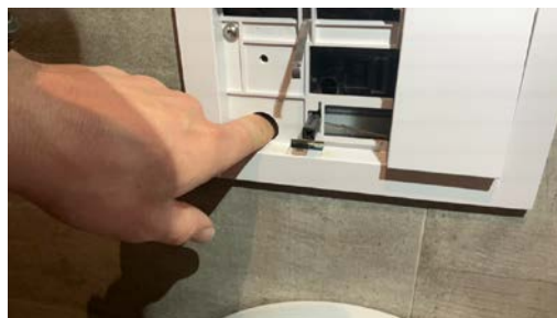
Indikasjoner på at systerne ikke er montert i henhold til monteringsveiledning.
