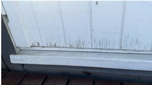
Verandadør bærer preg av slitasje.
