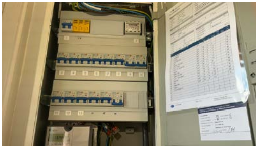
Sikringsskap i entréområdet.
