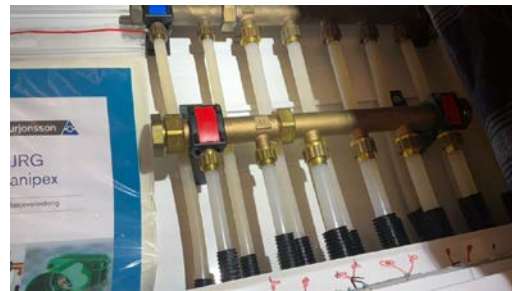
Fordelerskap på vaskerom. Utett fordelerskap.
