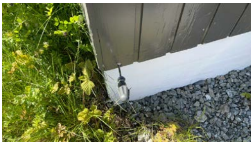
Råteskadet kledning registrert.
