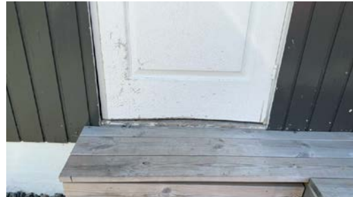
Dør til utvendig bod er defekt. Forholdet gis tilstandsgrad 3.
