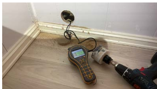
Hulltaking er utført, fuktmåling viste tørre verdier. 15 vektprosent viser at det er noe fuktpåkjennning, men ikke skadelige verdier. Dette må sannsynligvis sees i sammenheng med rom under terreng i rapporten. Det anbefales å følge med på videre utvikling.
