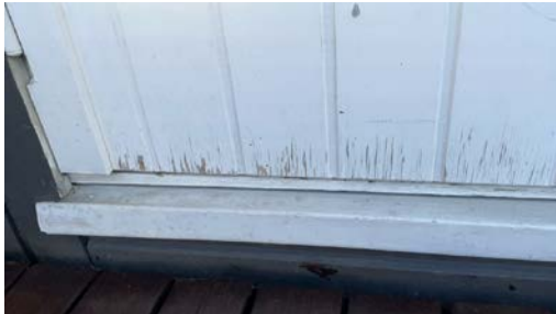
Verandadør bærer preg av slitasje.
