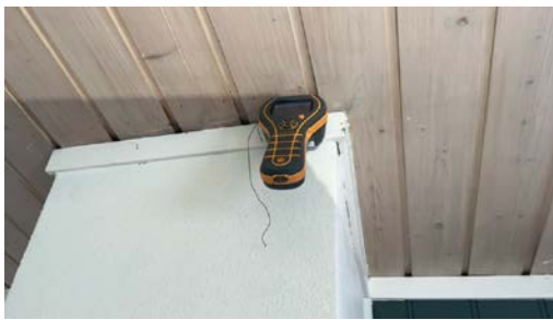
Fuktmerker rundt pipe. Enkel fuktmåling viste tørre verdier.
